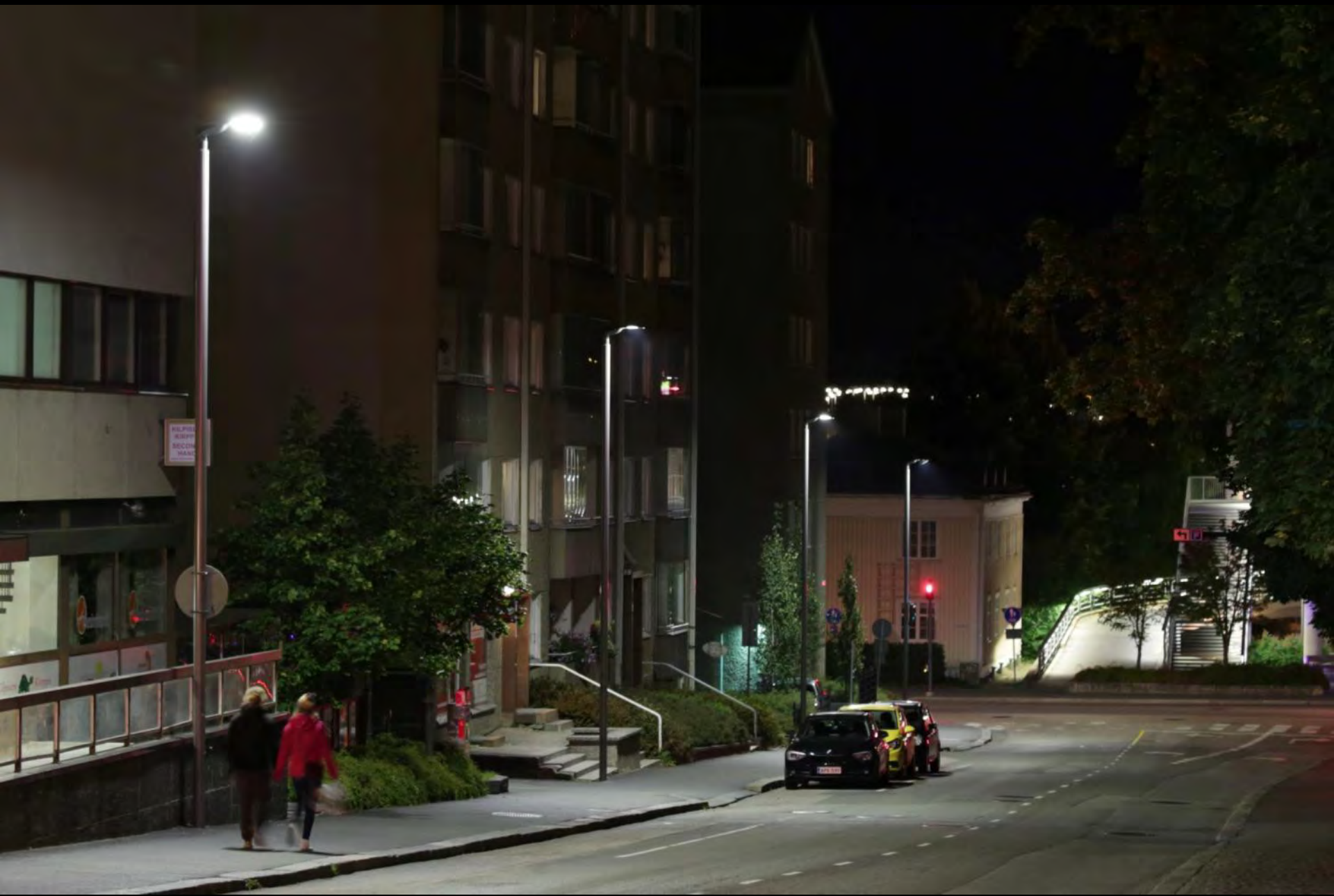
Ruutukaavakeskusta asennetaan katu kerrallaan uutta ledivalaistusta häikäsemättömällä WOW-valaisimella toteutettuna. Kuvassa Kilpisenkatu, joka saneerattiin valaistuksen osalta vuonna 2015.
