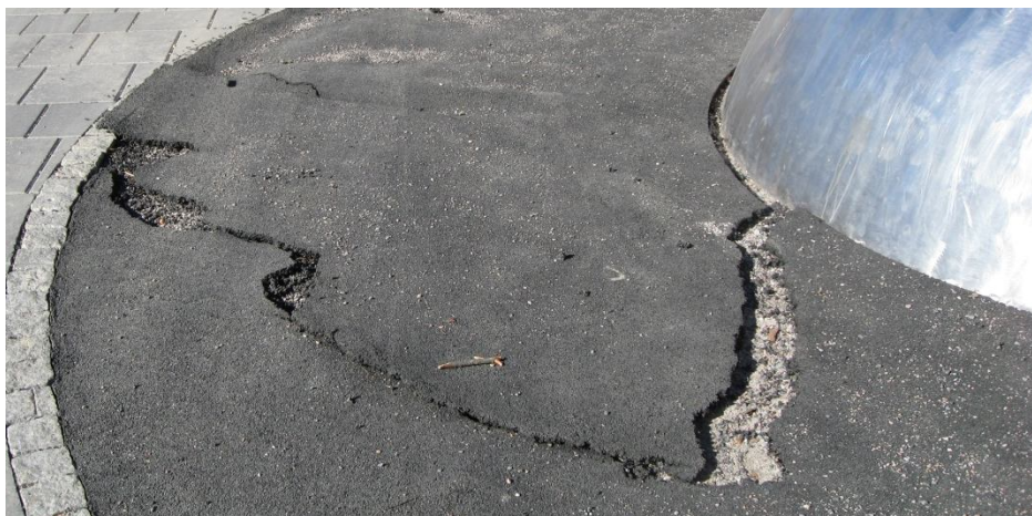
Kuva 4. Ohut kivituhkapohjalle tehty alusta Vantaalla repeytyi heti ensimmäisenä keväänä harjakoneen ajaessa sen yli (Viitanen 2016).
